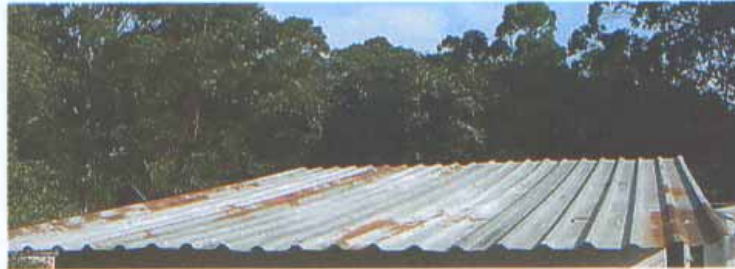
Foto 2 – Vista da cobertura com telhas envelhecidas.
